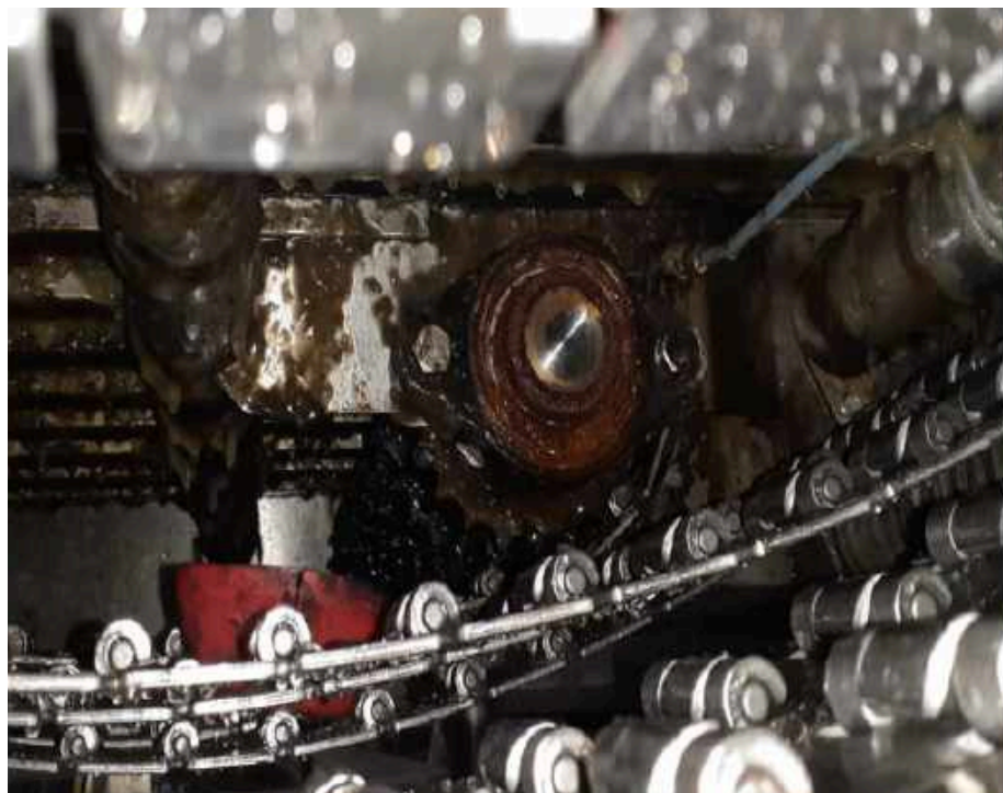
Figura 40 - Exemplo de mancal danificado por falta de lubrificação
